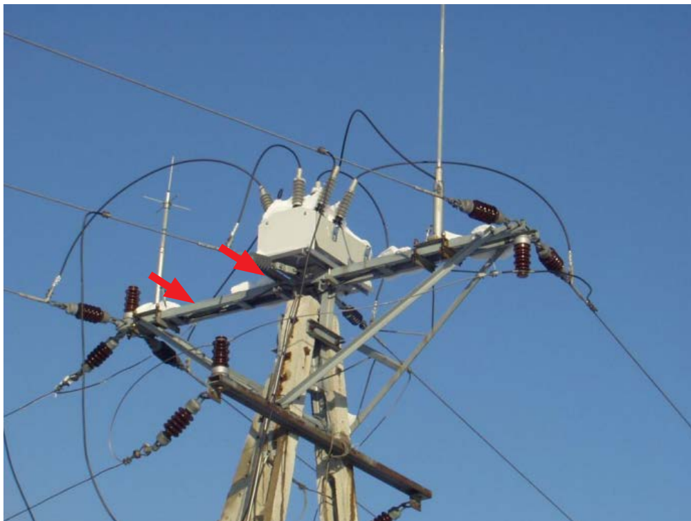
Rys. 40. Brak właściwych odstępów bezpiecznych między wyjściami niskiego napięcia przekładników a konstrukcją nośną wykorzystaną do odprowadzania prądu piorunowego.
