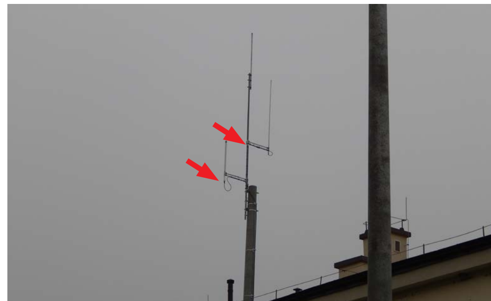
Rys. 37. Okablowanie anten radionadawczych prowadzone wzdłuż przewodu odprowadzającego prąd piorunowy.
