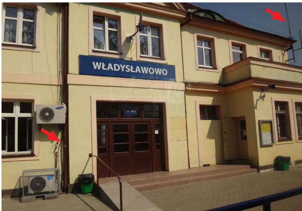
Rys. 35. Różnorodne instalacje elektryczne, radionadawcze i klimatyzacyjne prowadzone wzdłuż przewodu odprowadzającego prąd piorunowy.
