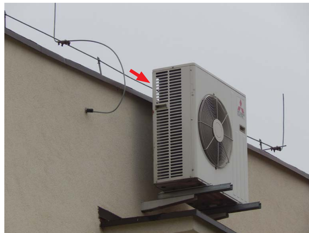
Rys. 33. Zwód poziomy na dachu bezpośrednio obok klimatyzatora.
