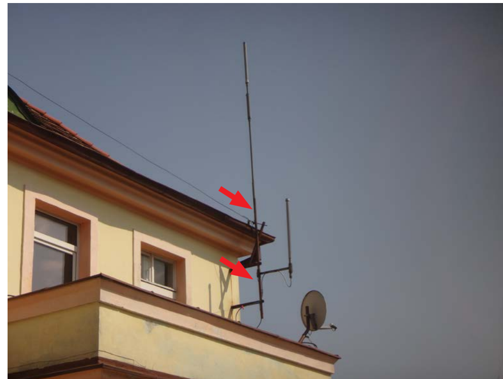
Rys. 36. Antena radionadawcza umieszczona wyżej niż zwód poziomy na dachu oraz podłączona do przewodu odprowadzającego prąd piorunowy.
