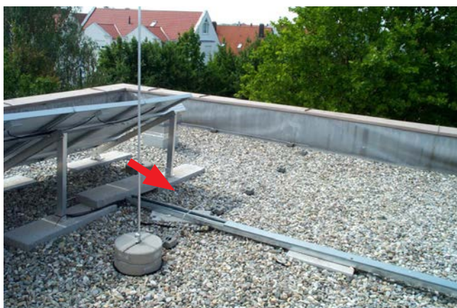
Rys. 41. Kable wyjściowe z paneli PV prowadzone za blisko przewodu odprowadzającego prąd piorunowy.
