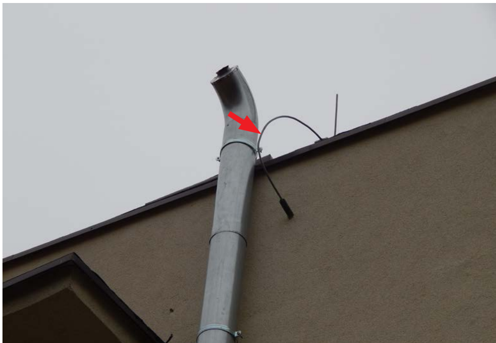
Rys. 34. Przewód odprowadzający prąd piorunowy w bezpośrednim sąsiedztwie instalacji kominowej i grzewczej.
