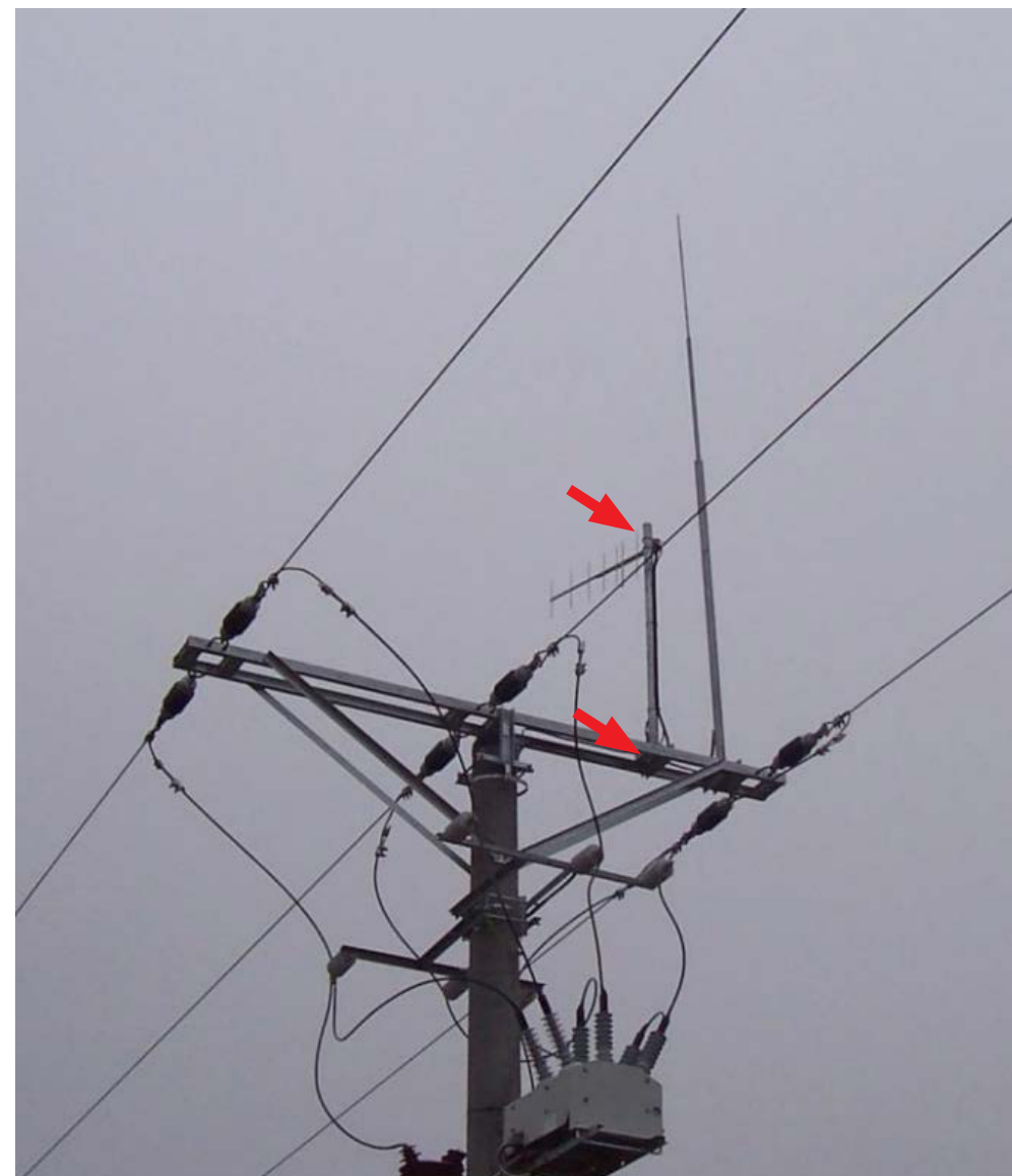
Rys. 39. Brak właściwych odstępów bezpiecznych między systemem radionadawczym a przewodem odprowadzającym prąd piorunowy.
